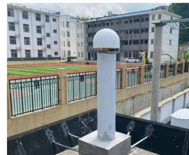
安徽六安金寨变电力北斗基站
